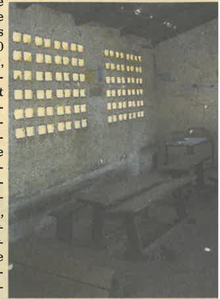
Der Zustand der Klassenräume ist katastrophal.
